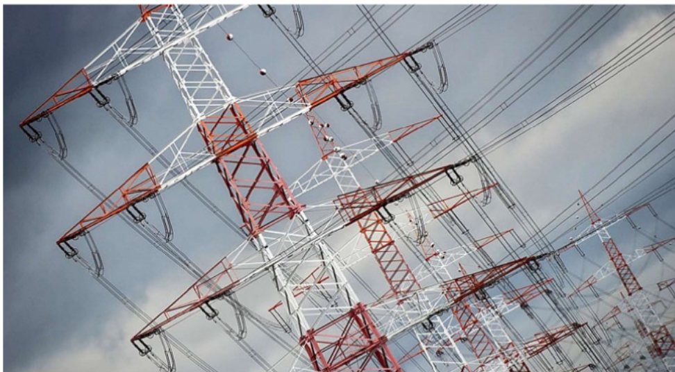
Das hessische Stromleitungsnetz ist laut einer Studie schon relativ gut ausgebaut.
